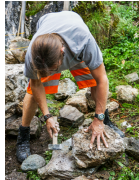
Einige der für die Mauer ausgewählten Bruchsteine gilt es zuerst noch zu bearbeiten.
